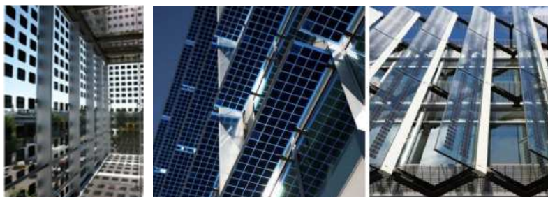
図 2-1-22 PV セルにより遮光されている様子 2-1-23) ~ 2-1-25)
