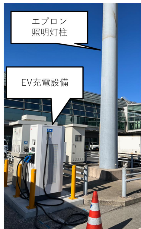
照明灯柱付近の設置事例 (東京国際空港第2ターミナル)
